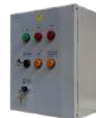
Шкаф ЩУДУ, стр. 104
