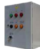
Шкаф ЩУДУ, стр. 104
